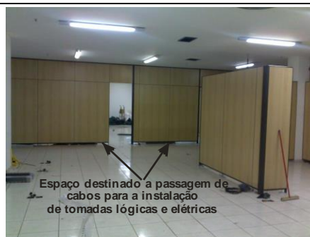
Figura 04: Espaço para passagem de cabos
