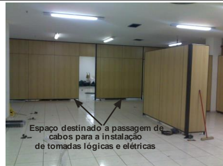
Figura 04: Espaço para passagem de cabos
